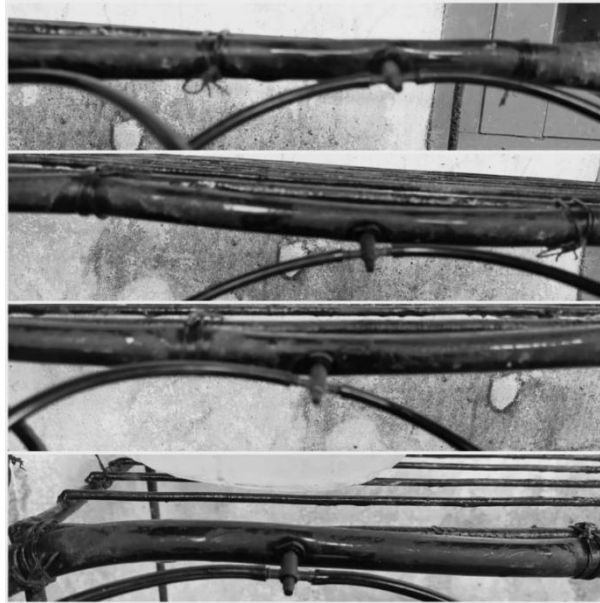
Gambar 4.8 Selang 16 mm dan 5 mm tidak ditemukan kebocoran.
