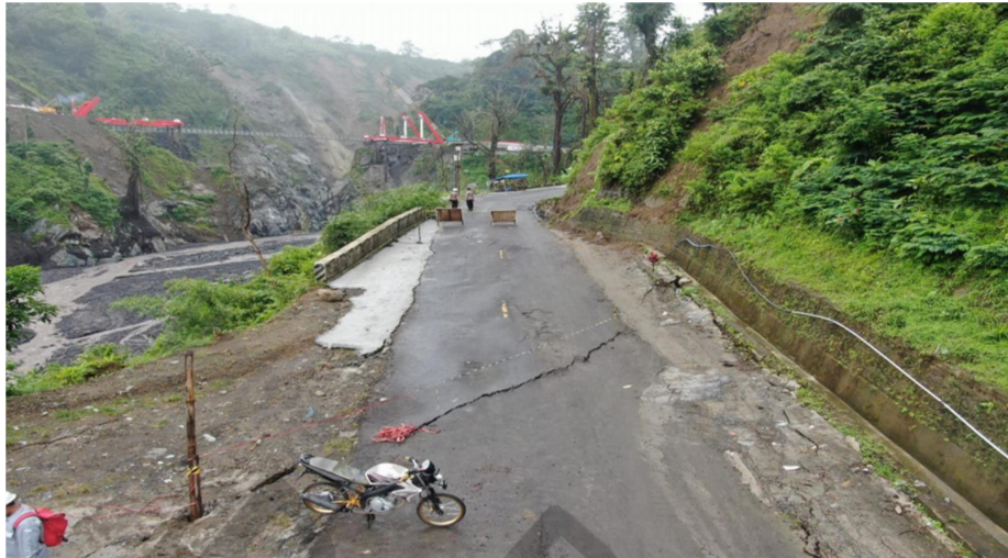
Gambar 1.2. Keretakan Setengah Lingkaran Pada Ruas Jalan pada tanggal 18 Oktober 2022.
